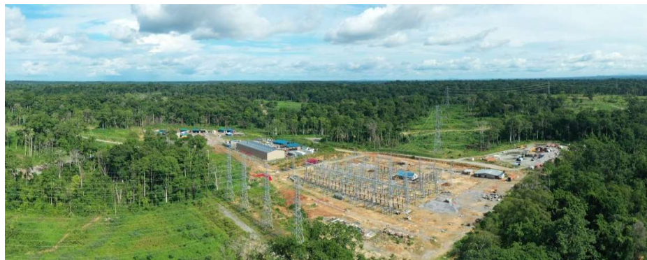
Poste électrique et ligne d'évacuation haute tension du projet du Nachtigal – 19 mai 2022
